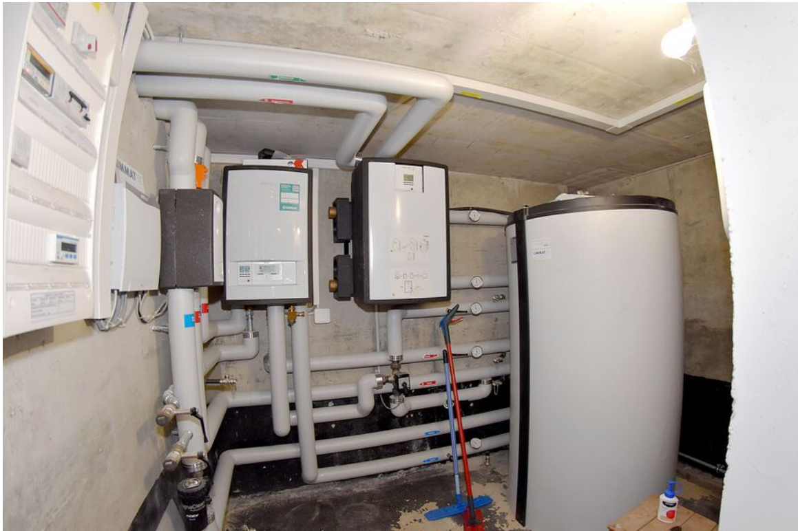
Heizung / Technik im UG
