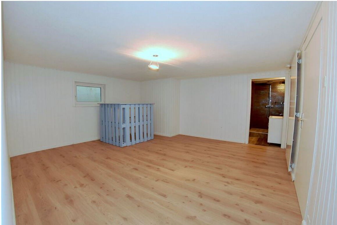
Beheizter Mehrzweckraum im UG (ca. 20 m 2 )
